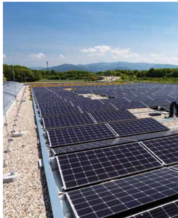
Zum Baustoff Holz kamen energetisch sinnvolle Ergänzungen wie beispielsweise eine leistungsfähige Photovoltaik-Anlage mit 147,6 KWP.
